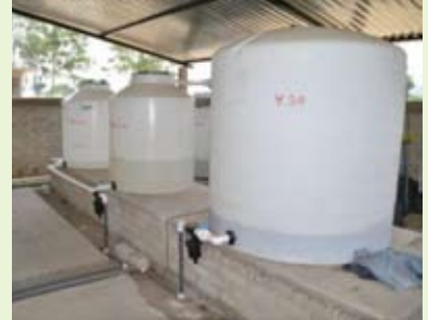
Centro de tanques de fertilizantes en la cabecera de control
